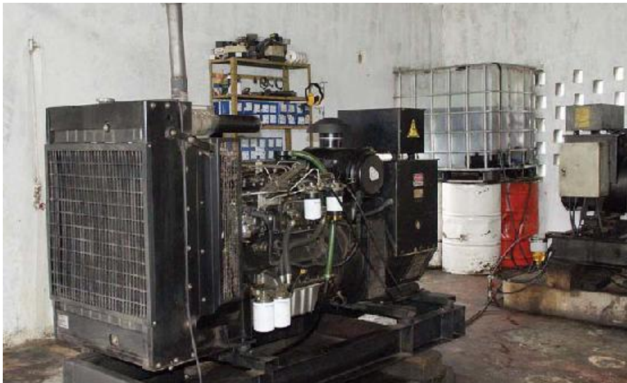
El generador eléctrico usa biodiesel para impulsar la planta de combustible diesel
